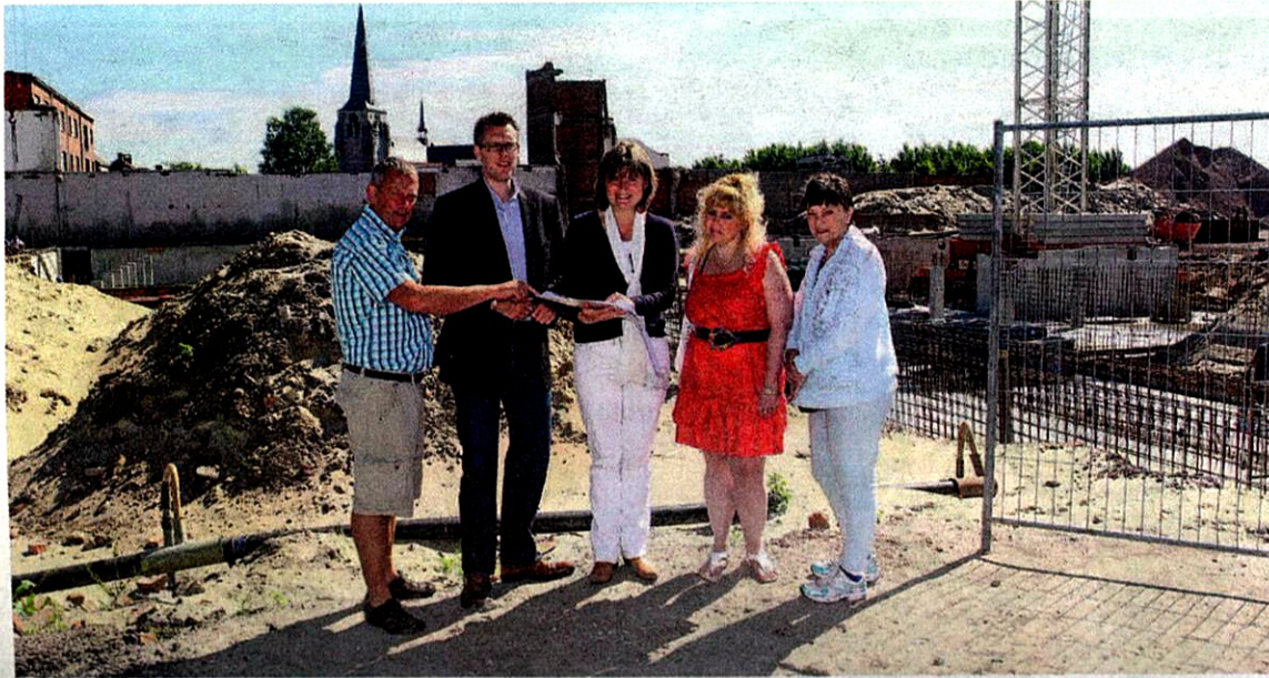
Nieuwe eigenaars Christel, Lydia en Jef volgen samen met Christophe en Leen van Vastgoed 03 de werkzaamheden. FOTO'S W&F
